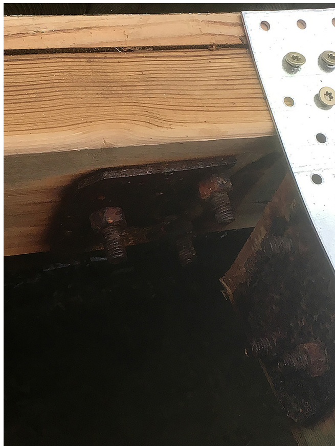
Skruvförbanden har gått helt av.
